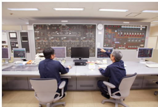
セントラル・エネルギー・プラントの中央監視システム
