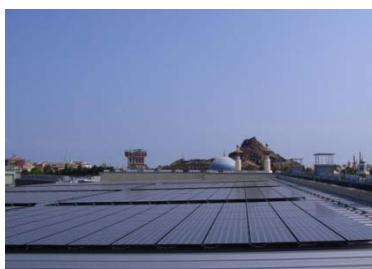
太陽光による自家発電設備
