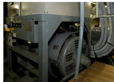
バージ内の発電機
