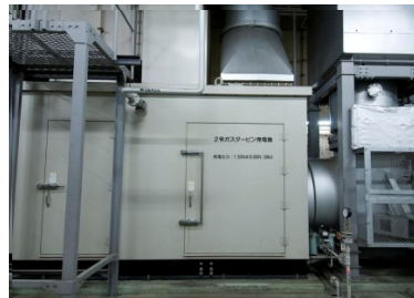
天然ガスを燃料とした自家発電設備
