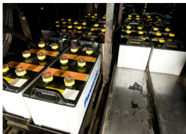
フロート内の充電式バッテリー
