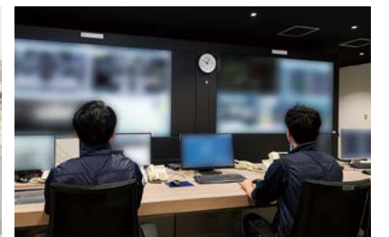
効率的な冷暖房を管理する、「セントラル・エネルギー・プラント」の中央監視システム
