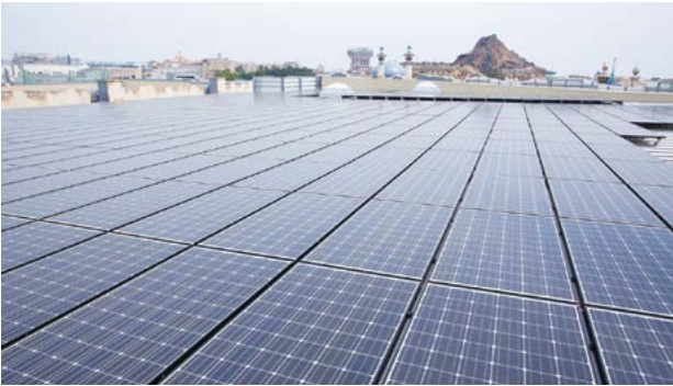
気候変動・自然災害： 社屋の屋上に設置した太陽光パネル
