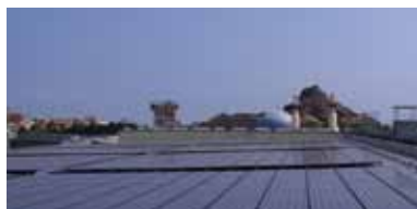
太陽光による自家発電設備
