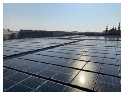
自社敷地内に増設した太陽光パネル
