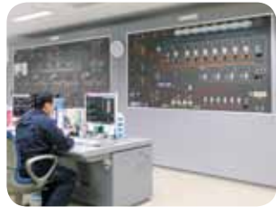
セントラル・エネルギー・プラントの中央監視システム
