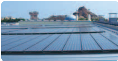
社屋の太陽光パネル
