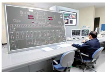
テーマパーク内で利用する 冷暖房用の「熱」を管理する セントラル・エネルギー・プラント
