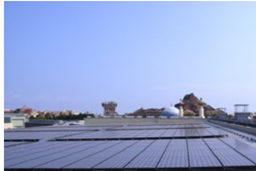
社屋の屋上の太陽光パネル
