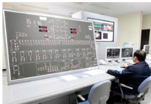
セントラル・エネルギー・プラントの中央監視システム
