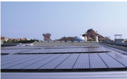
社屋の屋上の太陽光パネル
