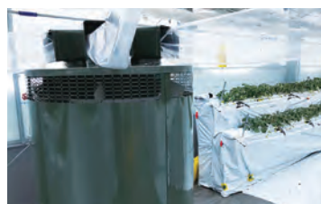
ハウスや株元を加温するための熱交換器
