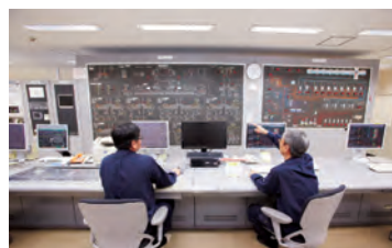
セントラル・エネルギー・プラントの中央監視システム
