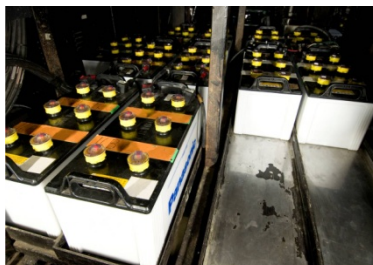
フロート内の充電式バッテリー
